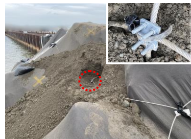
写真-22 結束部材の外れ確認
